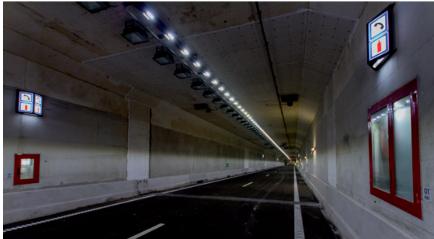
Figuur C.4 / Ledverlichting in de Tweede Coentunnel. (Foto: beeldbank Rijkswaterstaat/Harry van Reeken).
