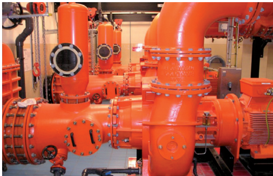
Figuur C.9 / Pompinstallatie.
