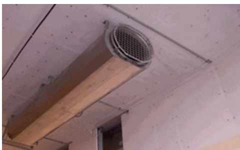
Figuur C.8 / Ventilatievoorziening in de tunnel.
