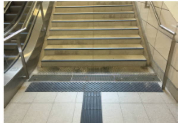
Bild 6 Stufenkantenmarkierung an einer Treppenanlage durch Bodenindikator basiertes Leitsystem in einer unterirdischen Haltestelle
