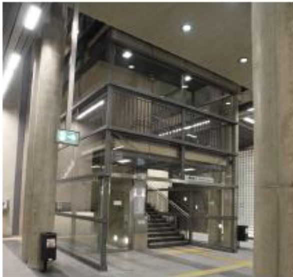
Bild 3 Brandschutzverglasung zur Einhausung einer Treppenanlage
