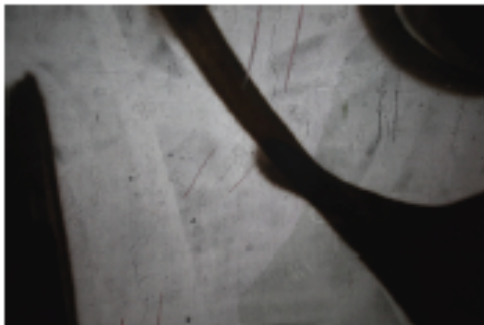
Bild 1 Gekennzeichneter Rissverlauf in einer Tunnelwand
