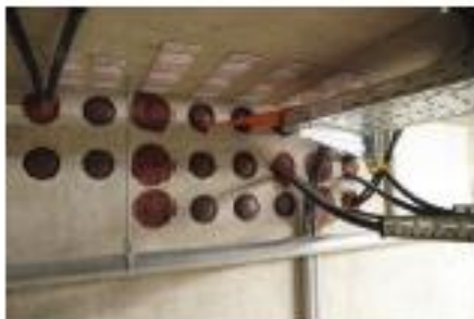
Bild 4 Zertifizierte Schottung von Leitungsdurchführungen mit zugehörigen Kennzeichnungen
