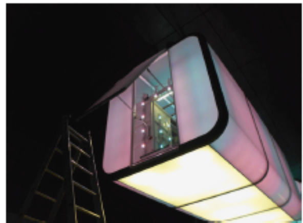
Bild 8 LED-Lichtcontainer: Tür (geöffnet) für Zugang im Rahmen von Wartungsarbeiten
